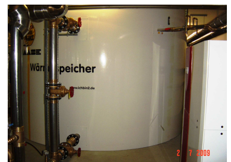
30.300 Liter Pufferspeicher mit 250 mm Isoliermantel
