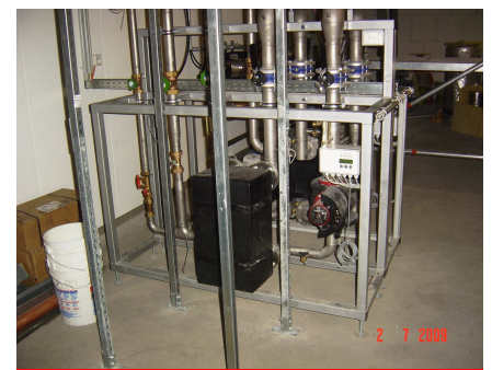
Frischwasserstation zur Warmwasserbereitung
